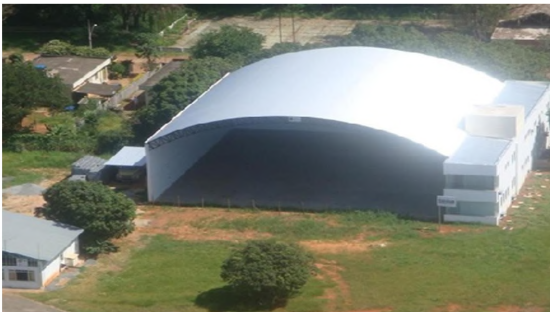
Foto 4: Nova sede da 3ª CORPAer instalada no interior do aeroporto da cidade de Montes Claros. Obra ainda não concluída. Fotografo: Délvio Duraes Filho. Mar. 2010
