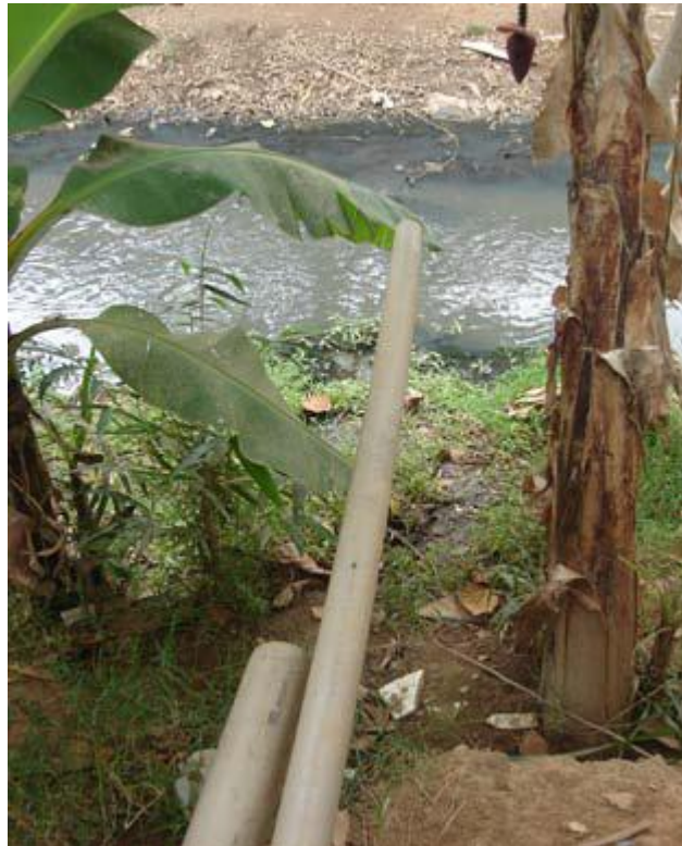
FOTO 7: Esgoto a céu aberto
