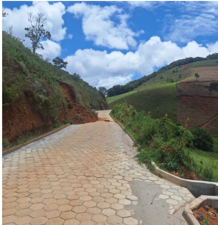
Fotografia 10: Ponto de deslizamento de terra na estrada do parque
