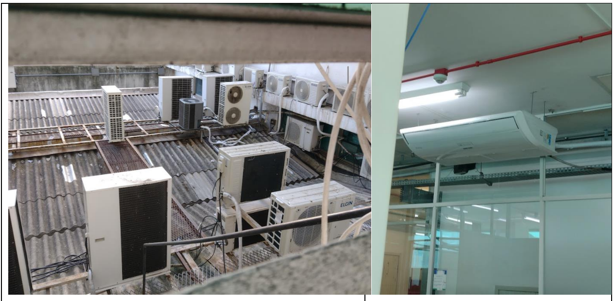
Fig. 4 - Sistema de refrigeração atual do Edif. Fábio Ruschi
