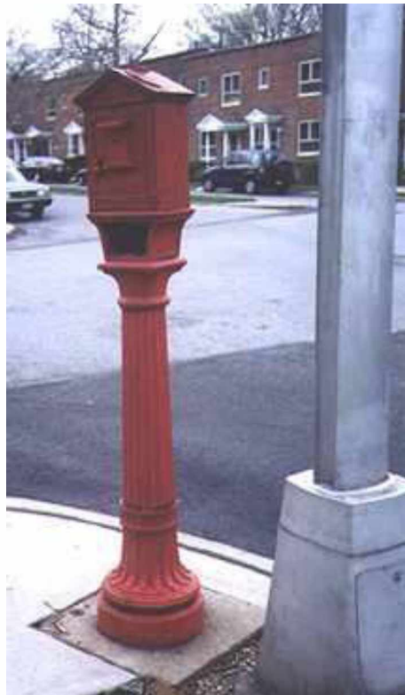
Figura 1 - Caixa de Alarme de Incêndio em uma esquina de Nova Iorque
