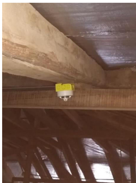
Figura 38 - Detector de fumaça localizado entre forros
