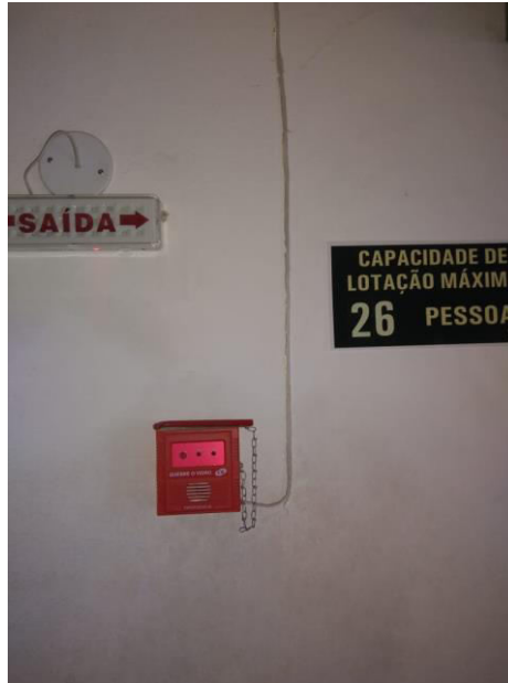
Figura 37 - Alarme manual para a detecção de incêndios
