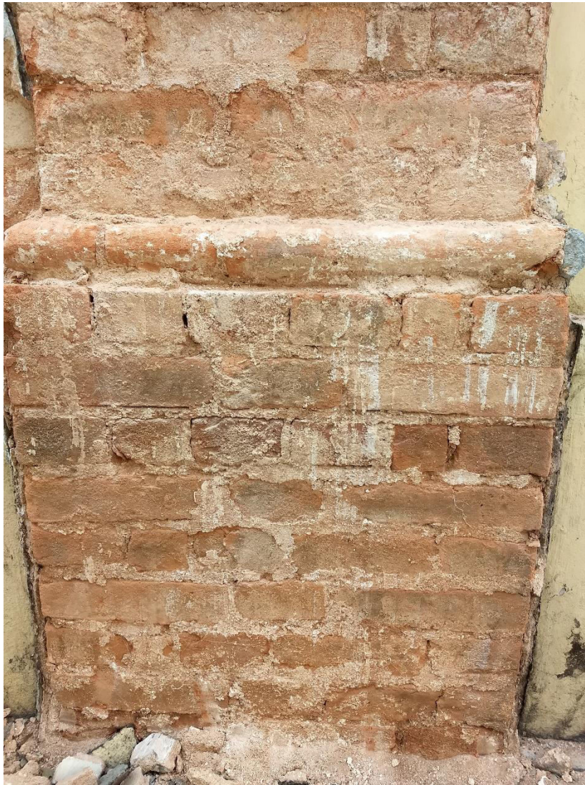
Figura 2 - Parede de tijolos cerâmicos da reforma do palacete Carlo Antonini em Belo Horizonte/MG
