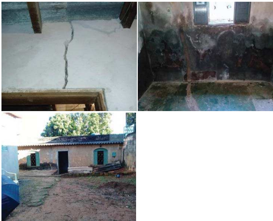
Fotografia 1 – Mapeamento de problemas relacionados à qualidade da habitação – Athis
