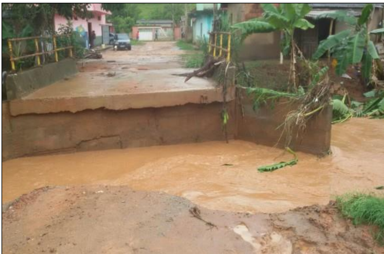
Figura 1- Ponte de acesso ao Distrito de Chonim de Cima levada pela enxurrada
