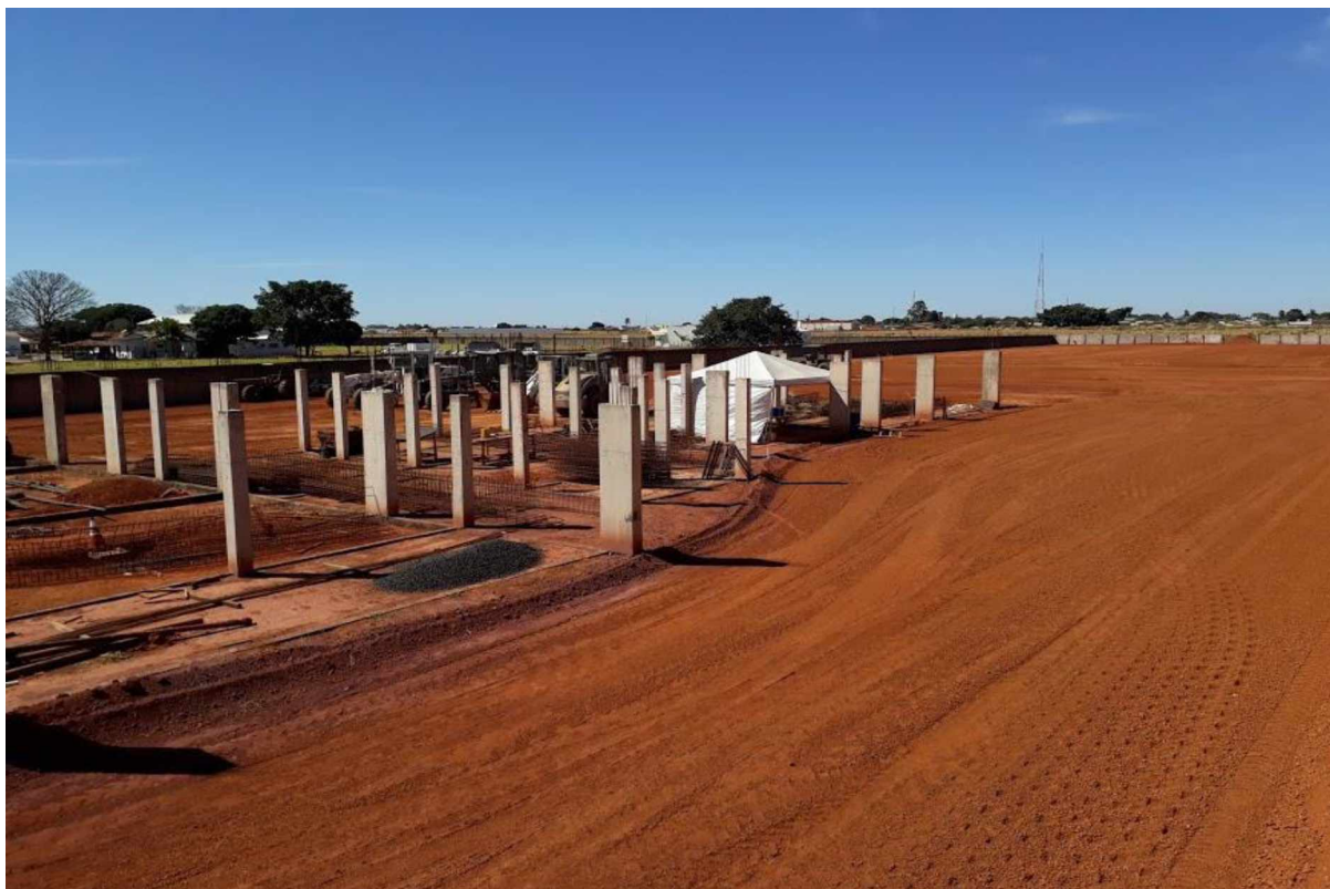
FIGURA 22: Trabalhos de terraplanagem para a construção da nova sede da 2ª Companhia de Bombeiros Militar.
