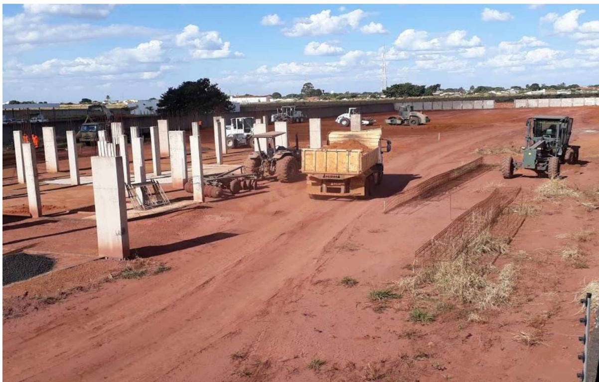
FIGURA 20: Trabalhos de construção da Nova Sede da 2ª Companhia de Bombeiros Militar.
